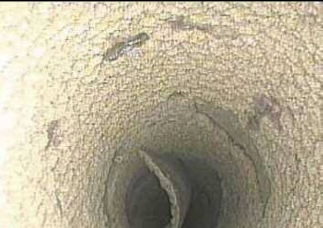
ボイラ内部(水管)スケール付着
