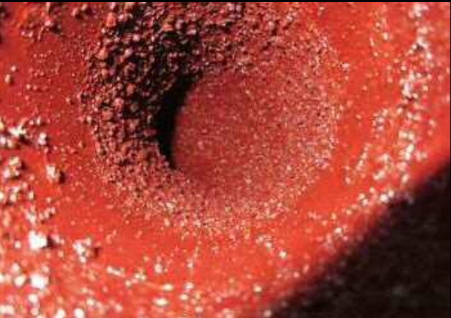
腐食(もらい錆から発生)
